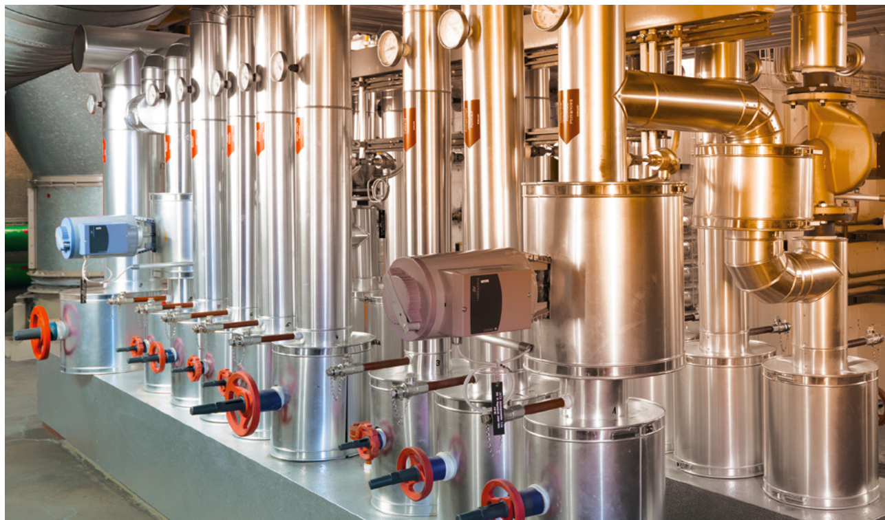
Die Stiftung KliK fördert Wärmeverbünde, die Abwasserwärme, Abwärme, Biomasse oder Wärmepumpen mit See-, Grund- oder Trinkwasser nutzen.
