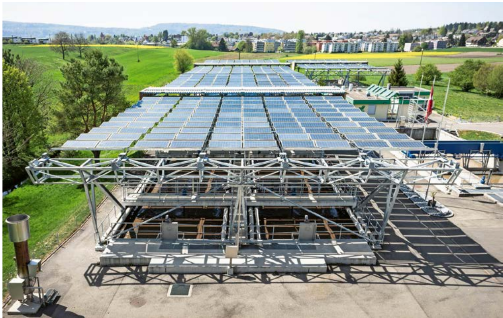
Auf der ARA Bassersdorf werden die grossen Flächen der Becken mit dem Solarfaltdach bestückt. Das deckt gut 20 Prozent des ARA-Strombedarfs ab. Quelle: dhp technology AG
