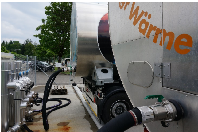
Bild: An die Kopplungsstation (Mitte) angeschlossener LKW für den Wärmeaustausch (Foto: erzo).
