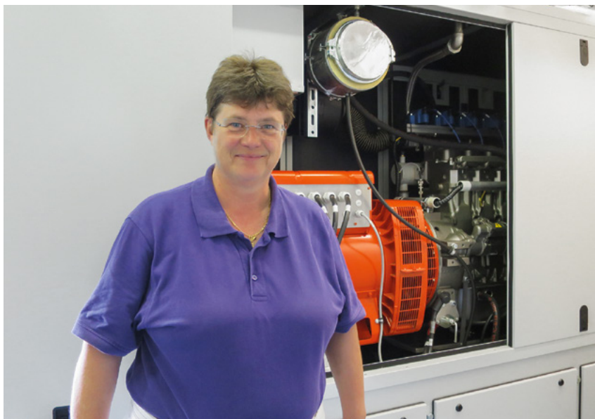
Fig. 1 Betriebsleiterin der ARA Höfe, Karin Thum, vor einem der neuen BHKW, für welches das BFE Investitionsbeiträge auszahlt.
