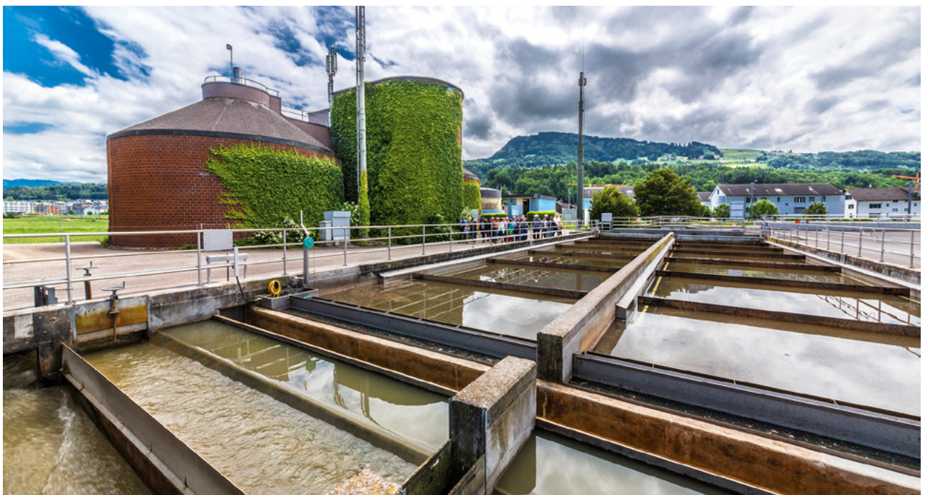
Lohnt es sich, ein Klärgas-BHKW zu betreiben? Ja, meint die Betriebsleiterin des Abwasserverbandes Höfe, Karin Thum.
