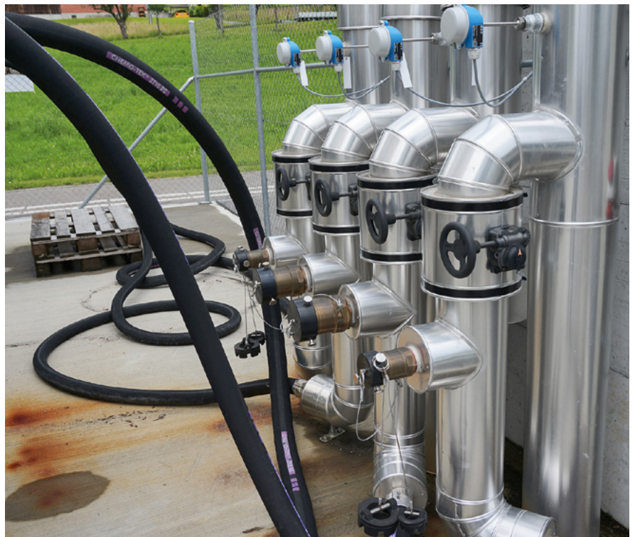
Fig. 4 Übergabestation beim Hallenbad Rothrist, der Prozess der Wärmeabgabe dauert rund 8 bis 10 Stunden.
