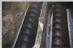
Raggio (Stazione di sollevamento)
