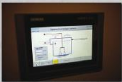
Al Roccolo (Stazione di pompaggio)
