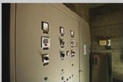
Resega (Stazione di sollevamento)
