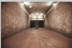
Spinée (Camera di chiarificazione)
