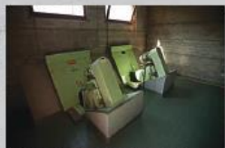
Resega (Stazione di sollevamento)
