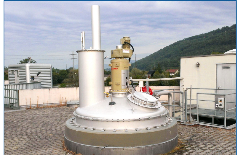
Gasdichte Schlammstapel-Abdeckung auf der ARA Aarburg
