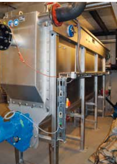
Abwasserwärmetauscher im Keller des Altersheims
