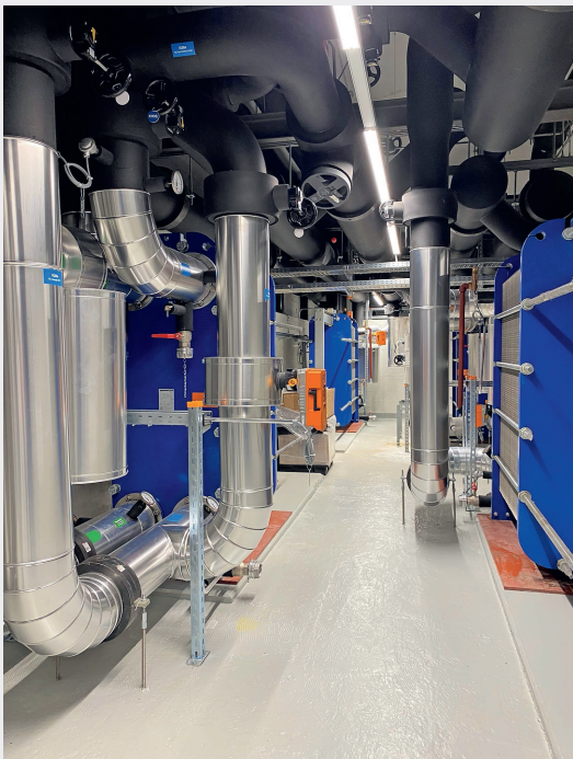
Fig. 3 In der See-Energiezentrale Inseliquai: Wärmetauscher.
